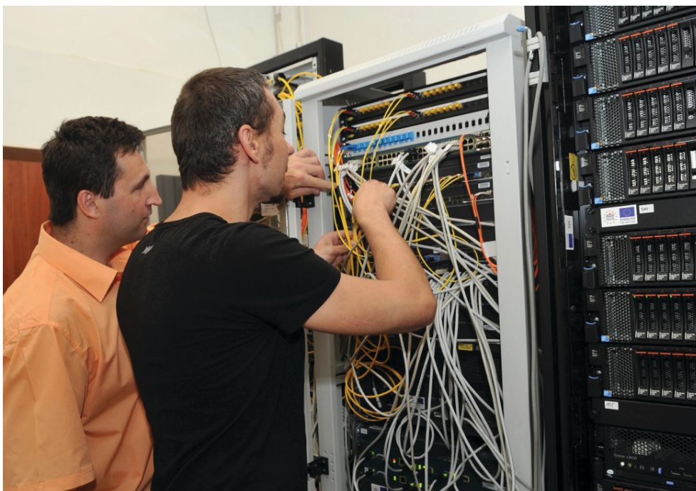
Pri riešení pracovných úloh – v serverovni
